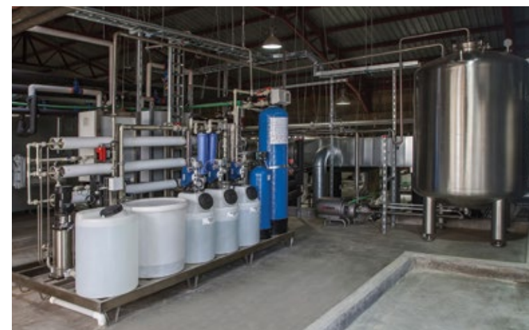
Pretratamiento de agua y generación de agua purificada (PW), incluyendo loop de distribución y tanque de almacenamiento.
